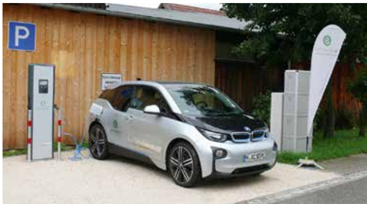
Abbildung 8: Ladesäule in Grabenstätt mit Fahrzeug aus dem Flottentest
