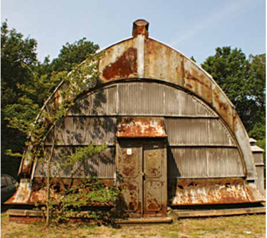
Korrosionsschäden beeinflussen die Standsicherheit des Meridianhauses Bildnachweis: Deutsches GeoForschungsZentrum (GFZ)
