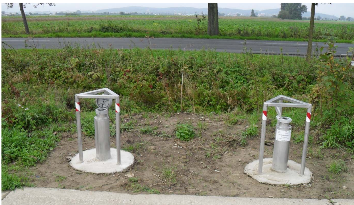
Abbildung 2: Messstellenbereich mit zwei Grundwassermessstellen
