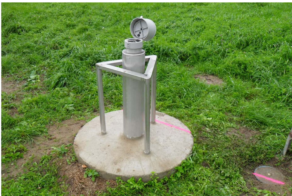
Abbildung 3: Grundwassermessstelle mit Höhenkontrollpunkt
