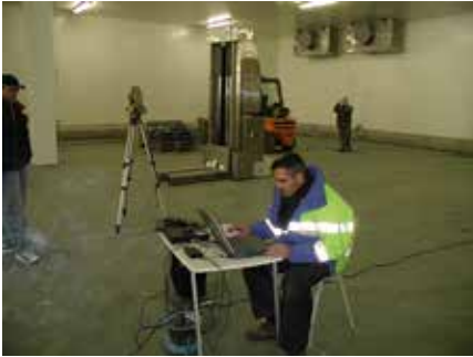
Installation und Koordinierung von Navigationshilfen für fahrerlose Transportsysteme
